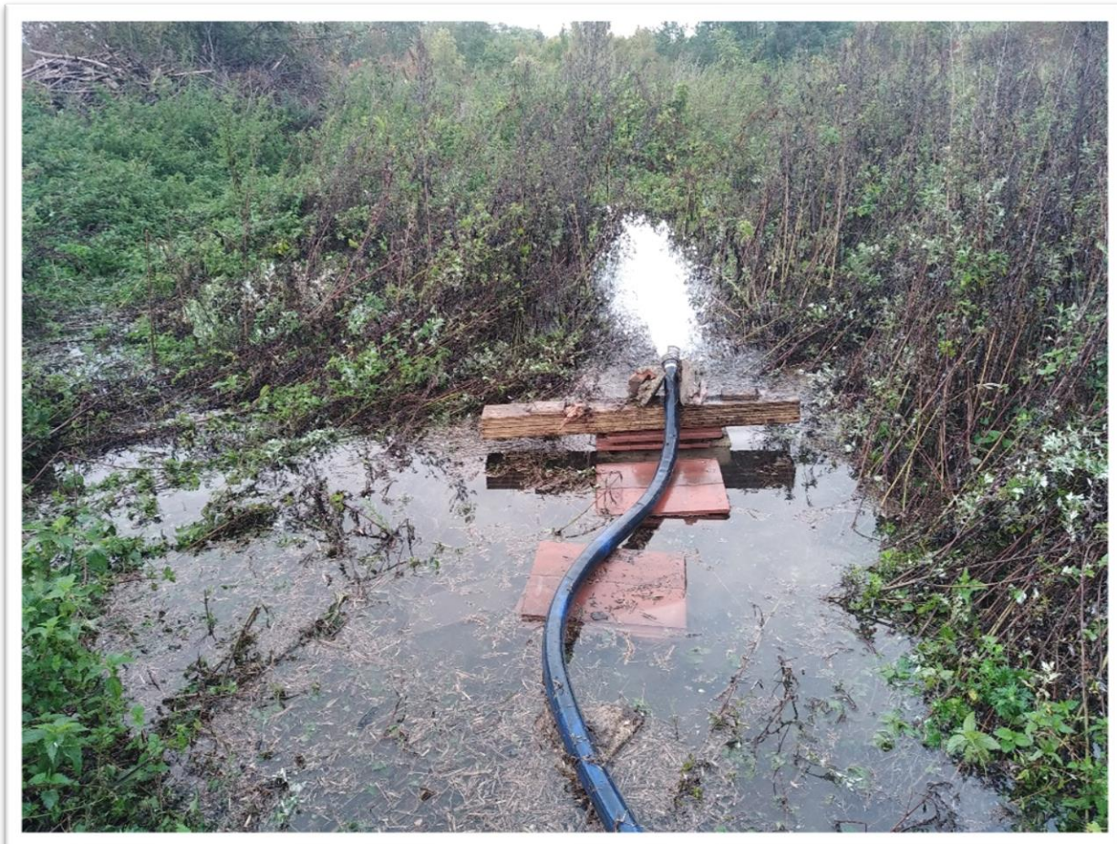
Figure 6 : Photographie du point de rejet des eaux d'exhaure
