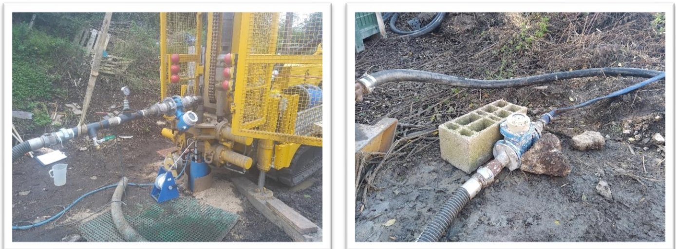
Figure 5 : Photographies des appareils de contrôle et de surveillance de débits
